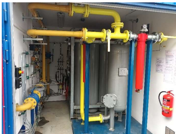
Kompresorová stanice CNG
