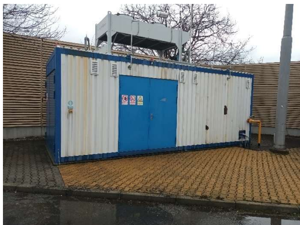
Kompresorová stanice CNG
