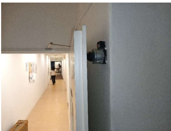
EPS (bezpotenciálový magnet na pož. dveřích)
