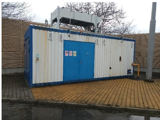
Kompresorová stanice CNG
