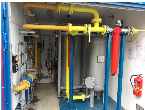
Kompresorová stanice CNG
