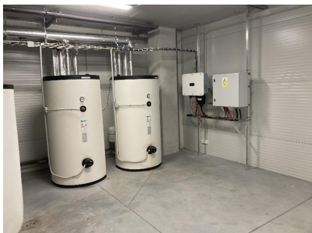
Střídač ve strojovně TČ
